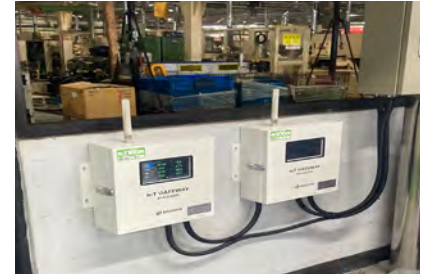
대동기어 대기배출시설 측정기기
